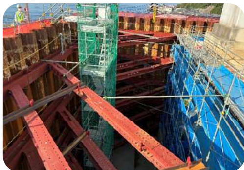
一般国道487号 道路災害防除工事（早瀬大橋P2橋脚耐震補強）3工区
